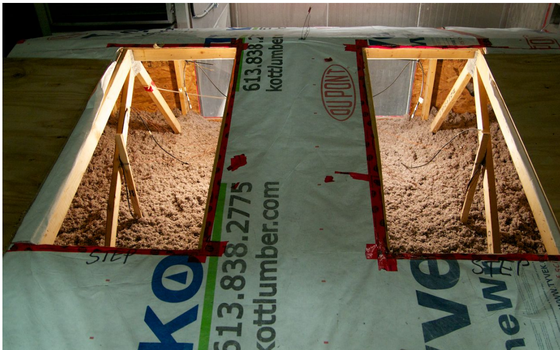
FIGURE 2.12 – Combles de la maison test isolés avec de la ouate de cellulose en vrac
