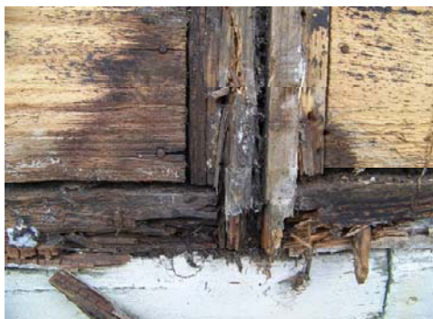
FIGURE 1.3 – Dégradation du bois due au passage de l'air exfiltré chargé de vapeur d'eau [Source : Enertech, Olivier Sidler]
