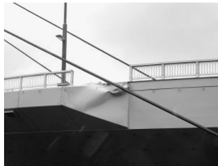
FIGURE 1.14 Effet des vibrations grandes amplitudes sur un pont à hauban, Japon, Matsumoto-2010
