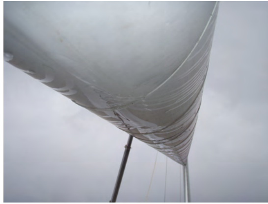
FIGURE 1.12 Formation d'un filet d'eau en surface de la gaine sur le viaduc de Millau (France).
