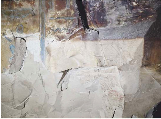
Fig. 13-14. TT 33. Même essai réalisé sur le pilier nord de la salle II, zone de cassure (S. Duberson).
