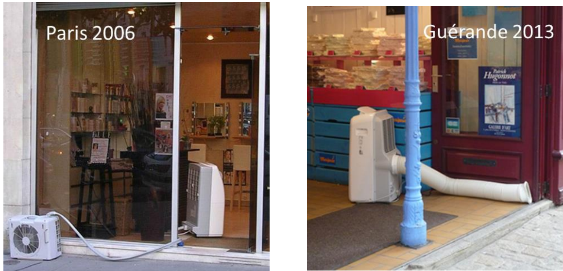
Figure 18 : Installation de climatiseurs dans des conditions sous-optimales dans des commerces
