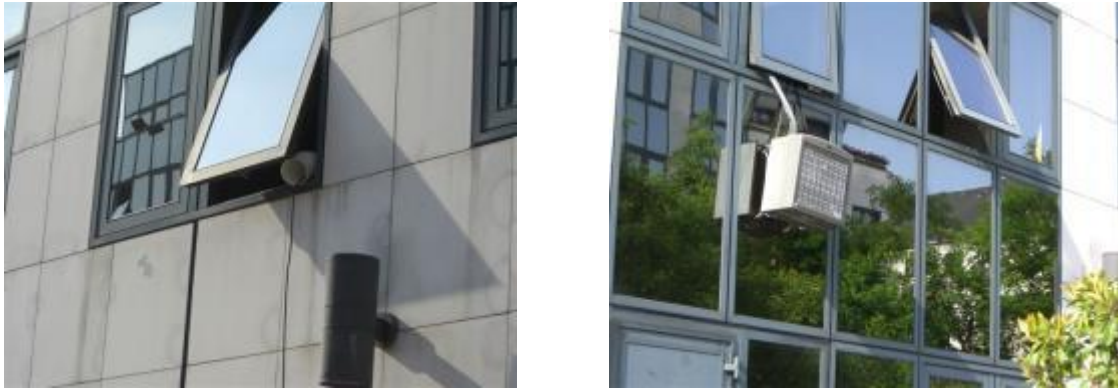
Figure 12 : Installation sans aucune précaution de climatisation individuelle dans un immeuble de bureaux (source : CSTB)
