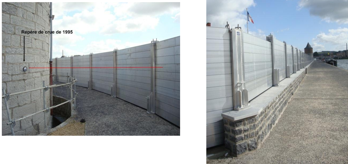
Figure 18 : barrière périphérique à Givet (produit IBS-ESTHI), visite du 14/09/2011, (photos CSTB)
