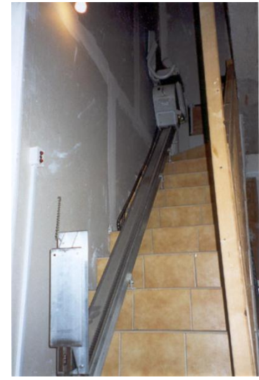
Figure 15 : monte-personne autonome en énergie pour accès à zone refuge (source : CSTB)
