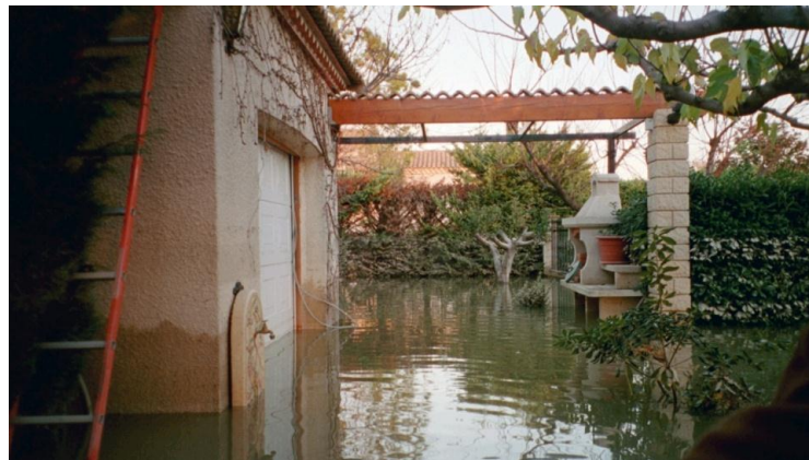
Figure 2 : trace de remontée capillaire dans l'enduit d'un mur partiellement immergé Inondation à Bellegarde (30) en 2003 (source CSTB)
