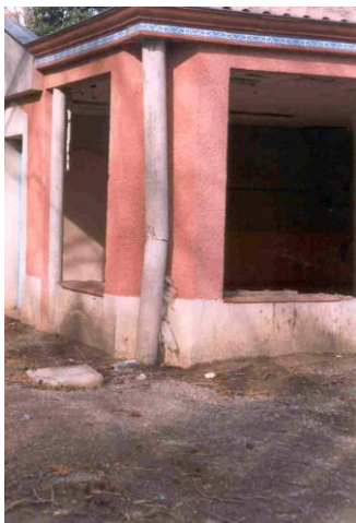
Figure 4 : enveloppe détériorée par une vague 5
